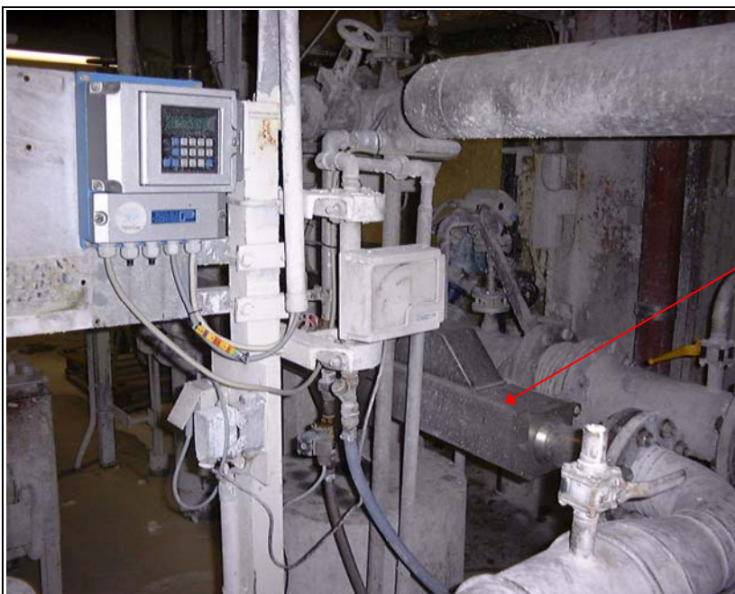
Установка расходомера Trio-Mass в реальных производственных условиях. Первичный преобразователь смонтирован после колена трубопровода.
