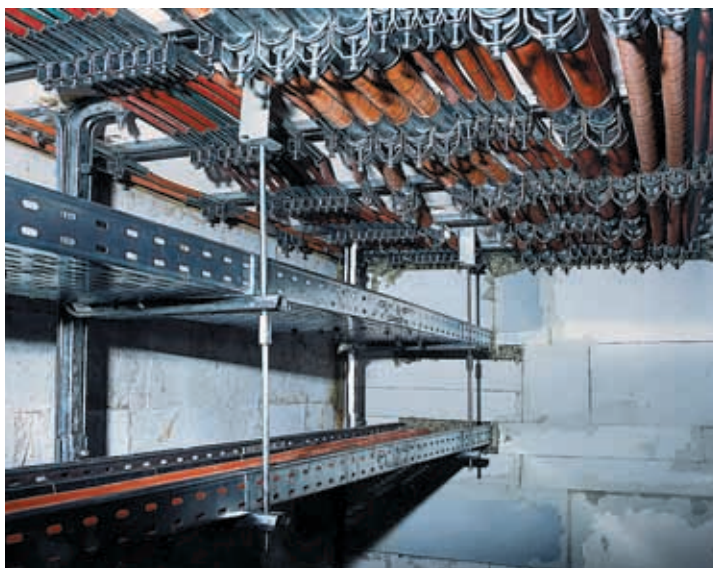
Перед тестом на пожаростойкость.
