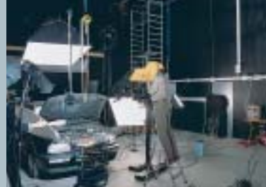
Прецизионная разводка электроэнергии в профессиональной фотостудии с помощью системы BD01.
